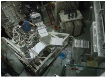
図2 分解中の蓄積リング高周波空洞系。中央の三角形の構造が漏水を起こしたサーキュレータ。
