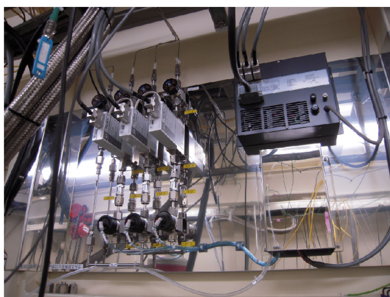
図1 高度化されたガス混合システム（BL11）
